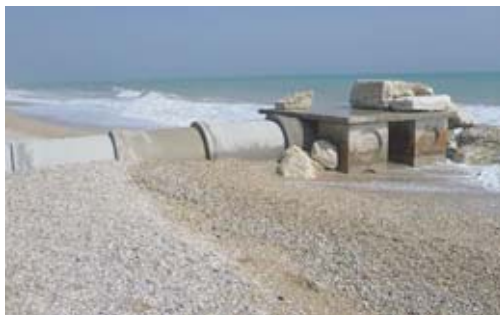
Foto 3.5.2. Scolmatore di piena a servizio della rete fognaria comunale.
